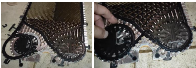
Рис. 2. Изношенная уплотнительная прокладка
